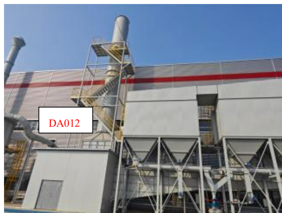
袋式除尘器及其排气筒 DA012
