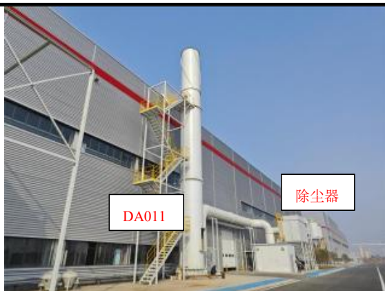
袋式除尘器及其排气筒 DA011
