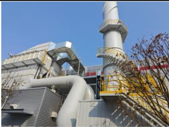
袋式除尘器及其排气筒 DA006
