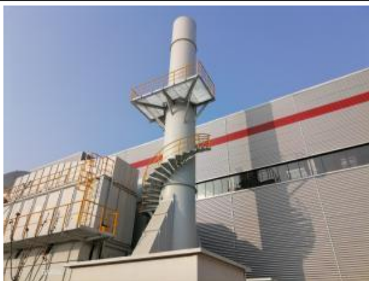
袋式除尘器及其排气筒 DA004
