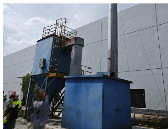
1 套滤筒除尘器及其排气筒 DA017
