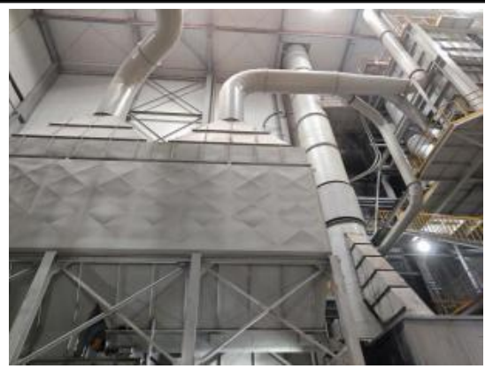
袋式除尘器及其排气筒 DA008
